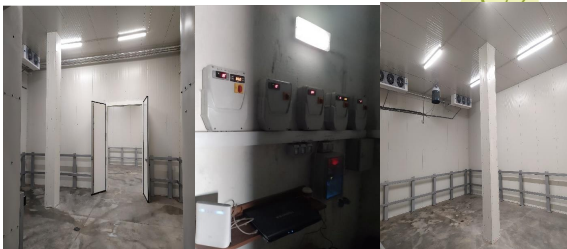
Foto 2. Aspecte din interiorul silozului de fructe - celule modernizate cu echipamentele de automatizare și control al sistemului de răcire și umidificare
